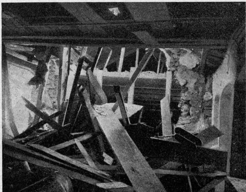
Разрушенія въ билліардной рестора „Саратовъ“.
