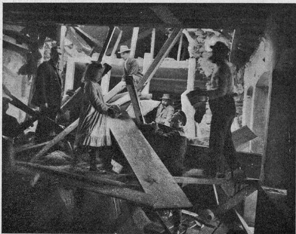
Разрушеніе въ бильярдной ресторана „Саратовъ“.
